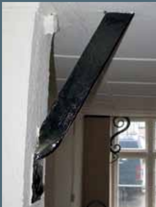
Her ses, hvordan knægten understøtter den bærende bjælke, hvor der før var en gavlmur. ▶
