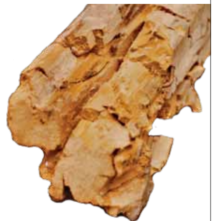
Bjælke totalt ødelagt af ægte hussvamp.
