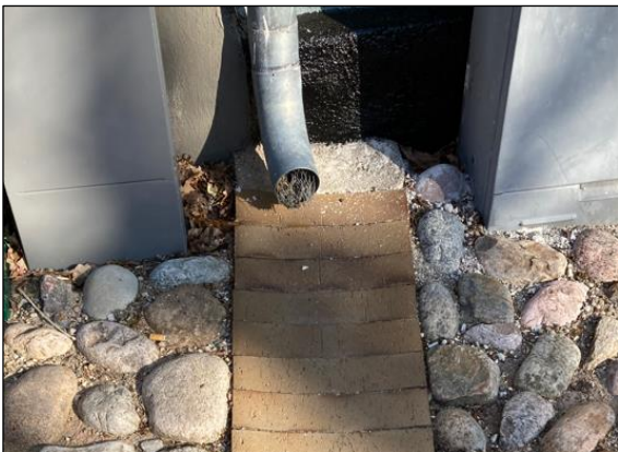
Figur 2.12. Trådnet i regnvandsnedløb kan være nødvendige i rotteplagede områder.
