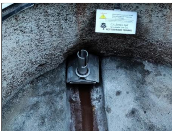
Figur 2.8. Skilt, der angiver, at der er en rottespærre monteret i brønden.
