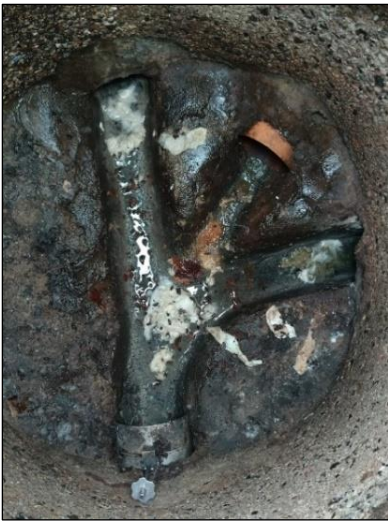
Figur 2.2. Brøndbund med mange aflejringer.
