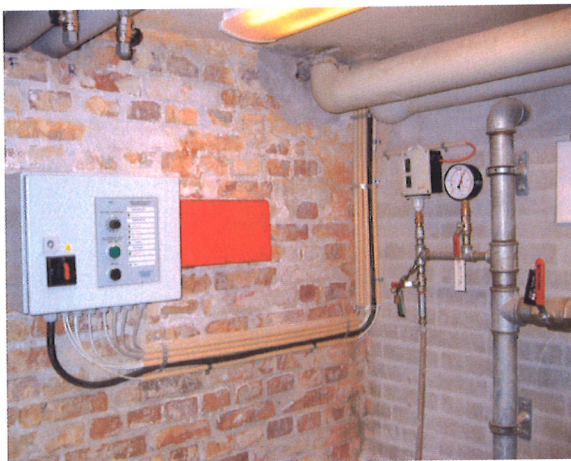
Sprinklercentral i kælder med betjeningspanel og sikkerhedsalarm.
