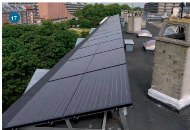
Solceller på tagstativer
